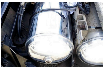
▲エアータンク
